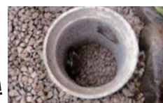
雨水浸透ます
